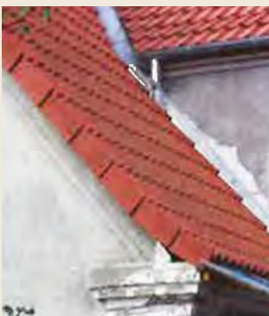
Det dårlige eksempel - en uelegant afslutningssten drukner gesimsen.
