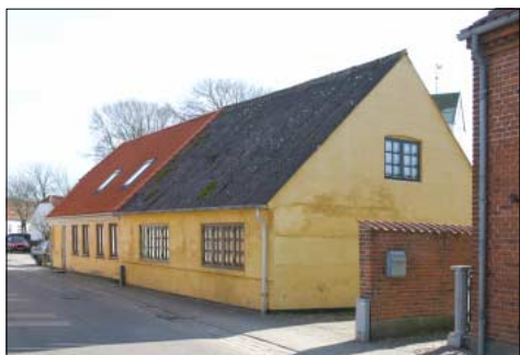
Rekonstruktion vil være mulig enten ved facaderenovering med vinduesflytninger og oplægning af nyt tag eller genopførelse som efter en brand.
