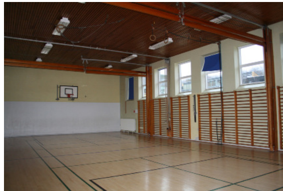
De eksisterende gymnastiksale er små og nedslidte, men i brug størstedelen af dagen.
